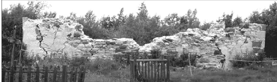
La maçonnerie en détérioration de la poudrière. (B. Lucki)
