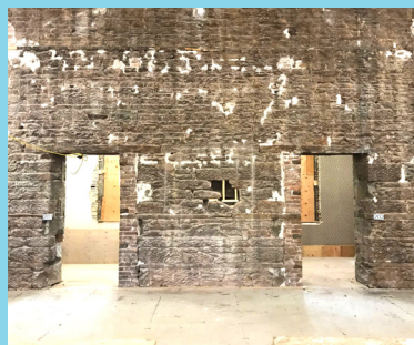
Une image du mur du pavillon ouest, situé dans la salle de la Confédération, avant le début des travaux de conservation.
