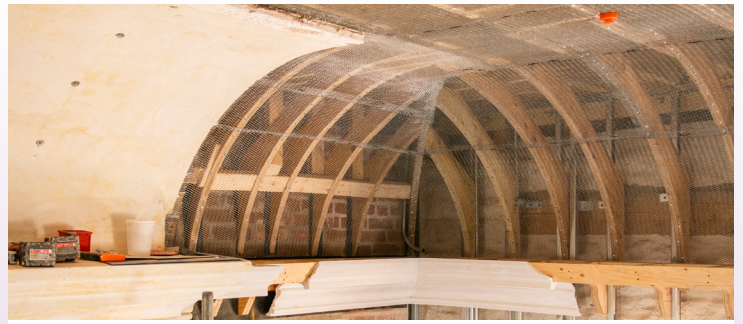
Une structure complexe et difficile à recouvrir de plâtre.
