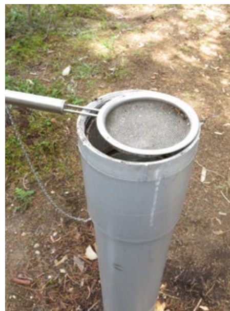
Tuyaux d'élimination des eaux grises
