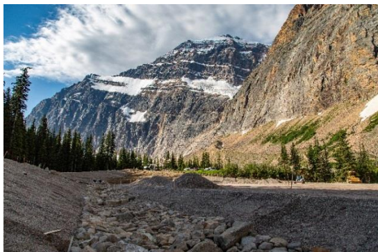
Travaux en cours à l'aire de fréquentation diurne du Mont-Edith Cavell. © Parcs Canada / S. Potter
